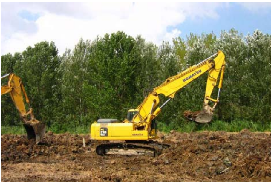
Figura 4.6. Scavo di uno stagno nell'area Righetti: due escavatori lavorano in serie. (Foto A. Bartolini)
