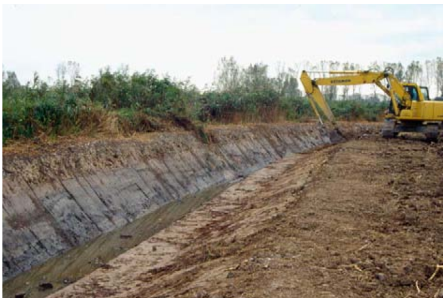
Figura 4.13. Fosso munito di banchina scavato lungo un tratto del perimetro dell'area Le Morette, al fine di ostacolare l'accesso a persone e predatori. (Foto A. Bartolini)
